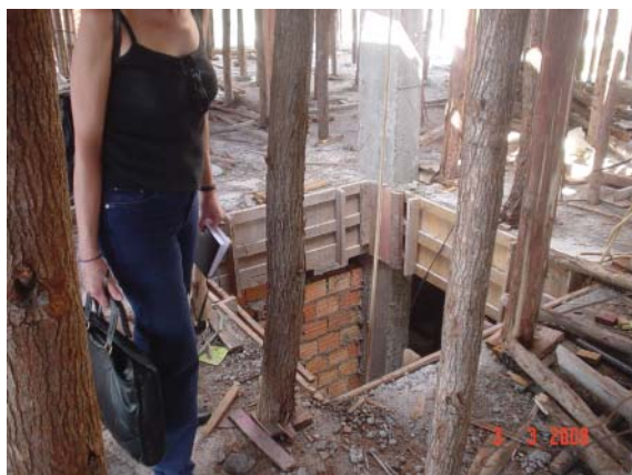
Figura 17 – Abertura de piso sem proteção
