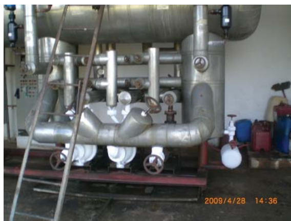
Figura 86 – Sistema de refrigeração industrial por amônia
