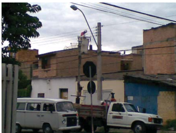
Figura 118 – Plataforma inadequada para trabalho em rede elétrica
