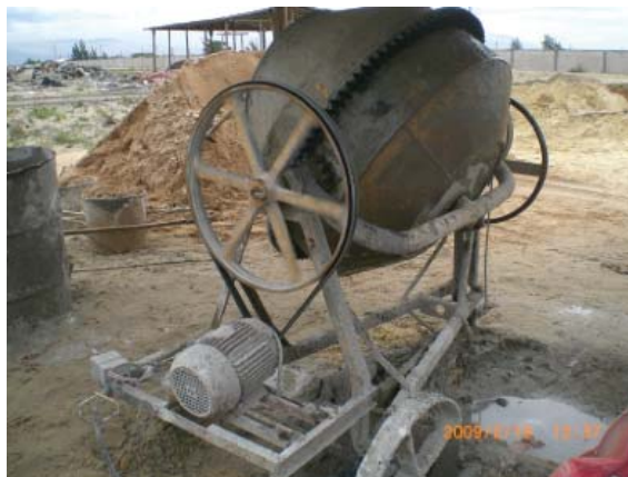
Figura 18 – Betoneira sem proteção
