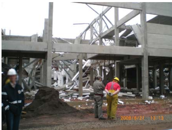
Figura 55 – Embargo por colapso estrutural
