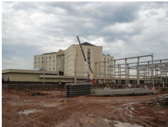
Figura 31 – Canteiro de obras sem sinalização
