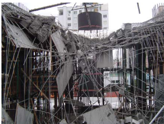
Figura 56 – Embargo por colapso estrutural do escoramento das formas
