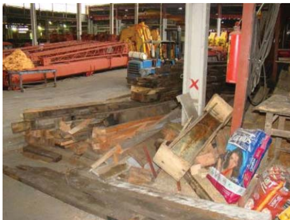
Figura 121 – Extintor de incêndio obstruído
