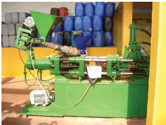
Figura 94 – Injetora sem proteção
