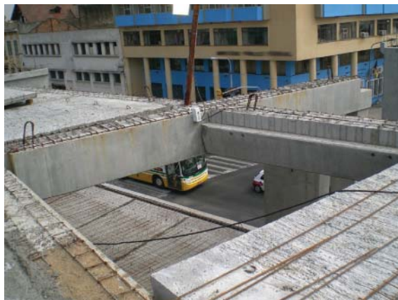
Figura 16 – Lajes com aberturas no piso sem proteção
