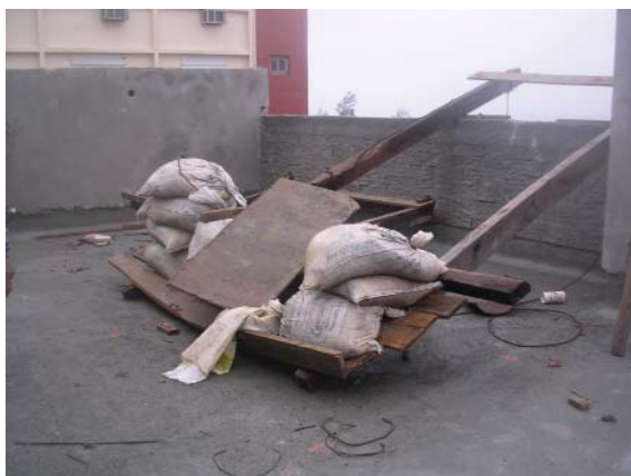
Figura 7 – Fixação e sustentação improvisada de andaime suspenso mecânico
