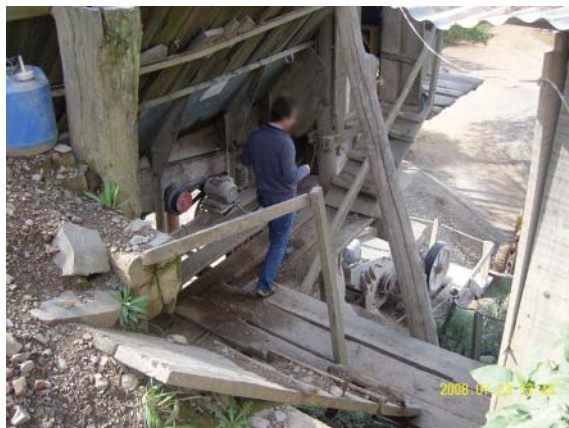
Foto 78 – Rampa de acesso improvisada
