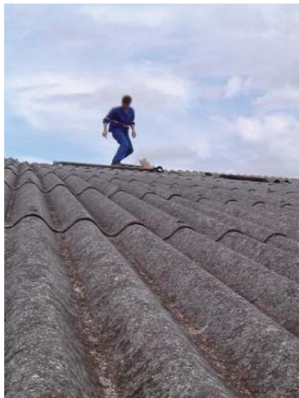
Figura 50 – Acesso e permanência precários nos serviços em telhado, com risco de queda de trabalhador
