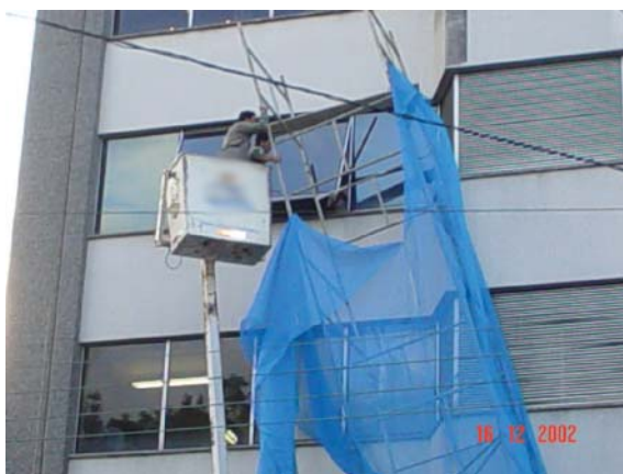
Figura 2 – Andaime em colapso estrutural
