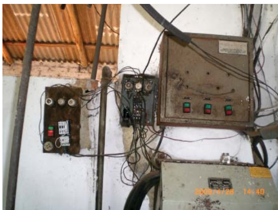
Figura 65 – Instalações elétricas improvisadas
