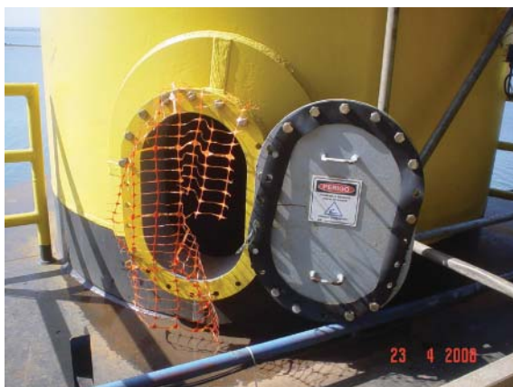
Figura 63 – Espaço confinado sem isolamento e precariamente sinalizado
