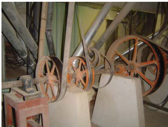
Figura 90 – Transmissões de força sem proteção
