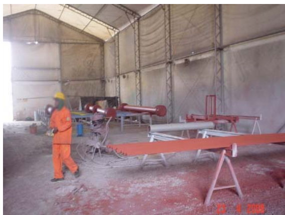
Figura 59 – Setor de pintura com a presença de isocianatos
