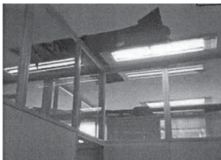
Figura 8 – Sala de prédio público com teto em condições inseguras
