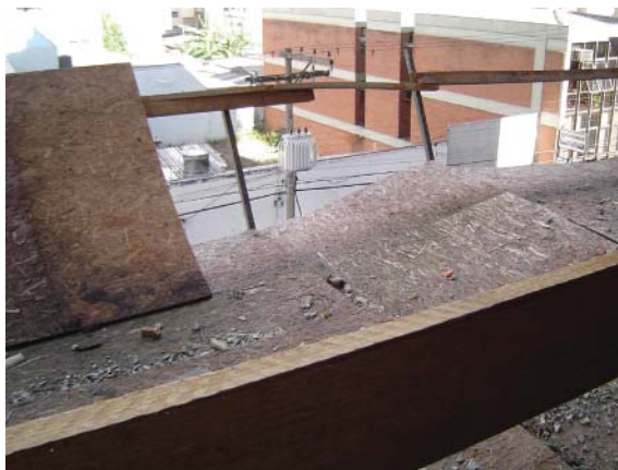
Figura 44 – Plataforma de proteção incompleta e não efetiva
