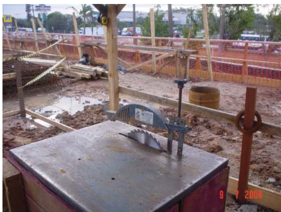
Figura 25 – Serra circular montada, com zona de operação sem proteção
