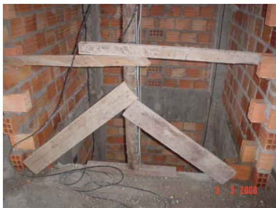
Figura 15 – Acesso à caixa do elevador com proteção inadequada
