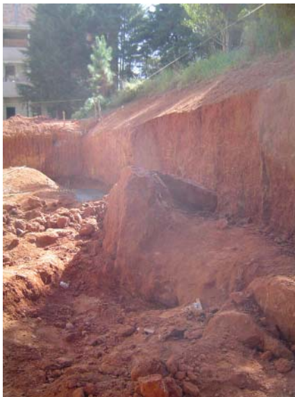
Figura 41 – Taludes sem estabilização
