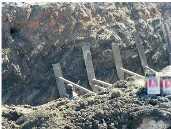
Figura 43 – Risco de colapso iminente
