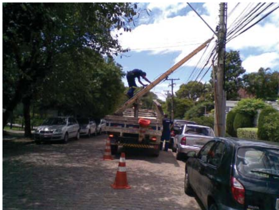
Figura 117 – Manutenção de luminárias com acesso improvisado
