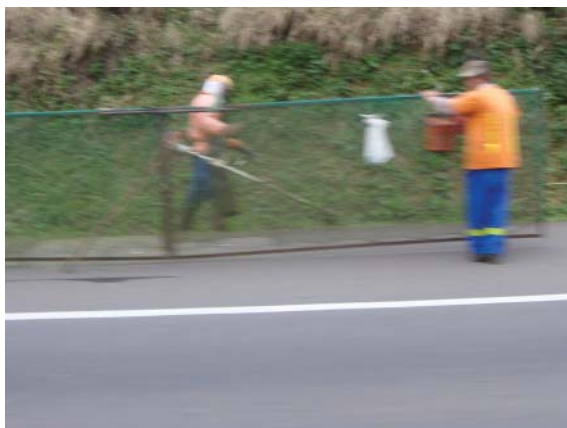
Figura 133 – Roçagem em rodovia com ausência de sinalização viária, proteção individual, rede de proteção em estado precário, fornecimento de água e armazenagem de inflamável inadequados
