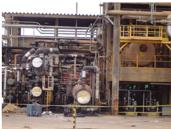
Figura 105 – Detalhe de unidade de craqueamento catalítico
