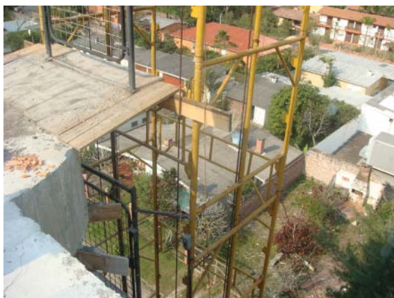
Figura 48 – Elevador com acesso inseguro
