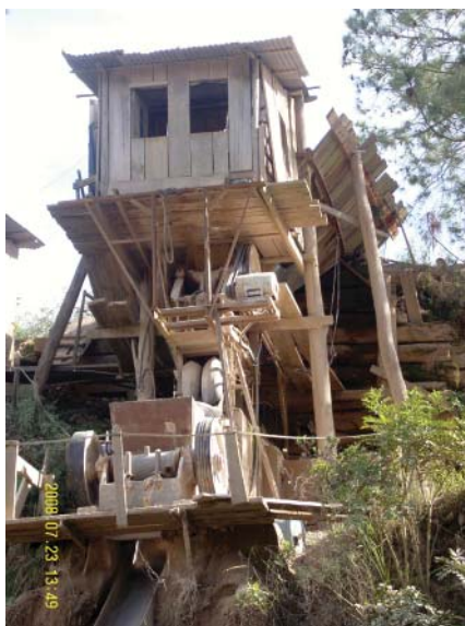
Figura 79 – Periferia sem proteção contra quedas
