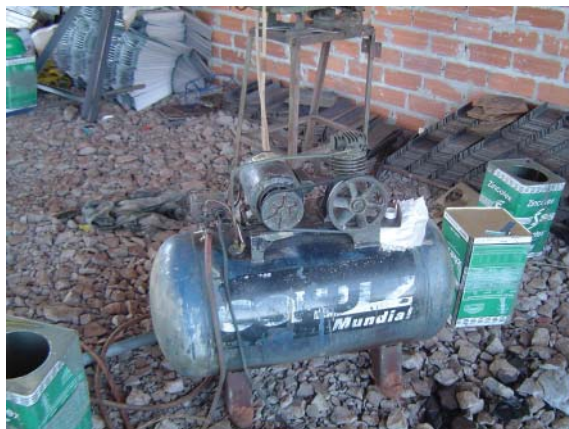
Figura 70 – Reservatório de ar comprimido
