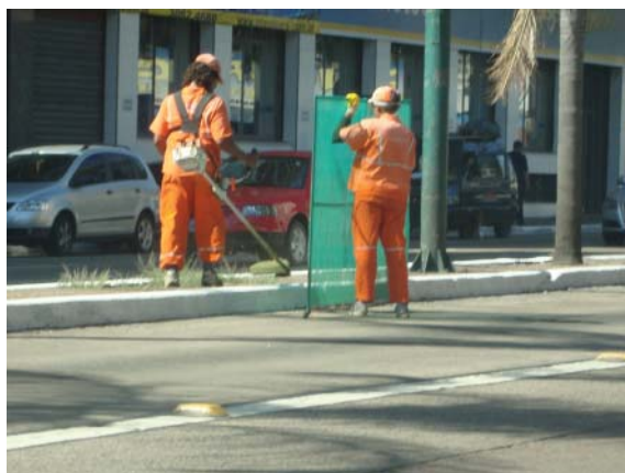
Figura 132 – Roçagem com ausência de sinalização viária e proteção individual
