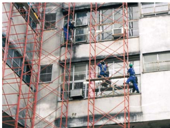
Figura 5 – Acesso precário a andaimes fachadeiros
