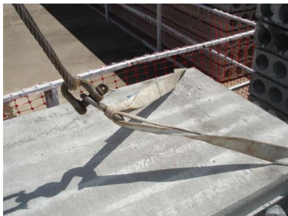
Figura 35 – Cinta de carga utilizada na movimentação e descarga de lajes pré-moldadas. Este equipamento é inadequado para a movimentação das lajes em questão
