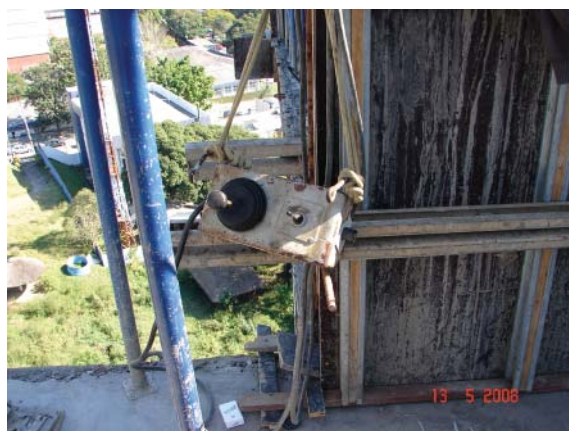
Figura 54 – Precariedade nos componentes de controle e movimentação
