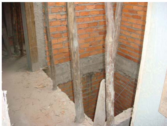
Figura 14 – Desproteção do acesso à caixa de elevador
