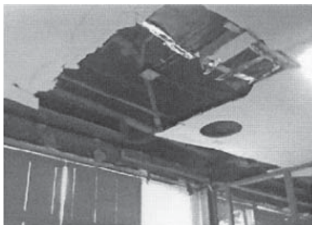
Figura 9 – Teto de gesso aberto. Partes do material já haviam caído sobre mesas e piso do local
