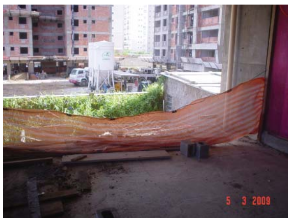
Figura 29 – Precariedade de alguns elementos de proteção oferecidos
