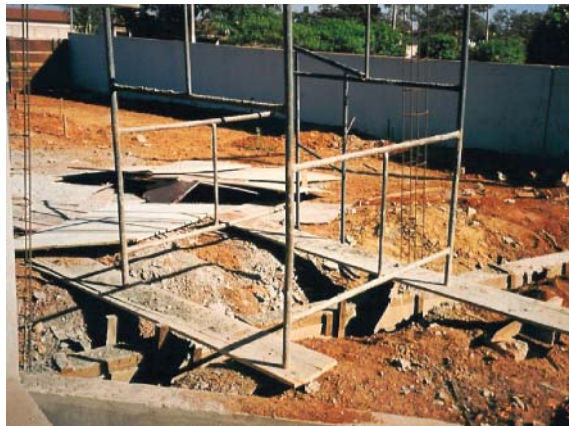
Figura 3 – Andaime precariamente apoiado
