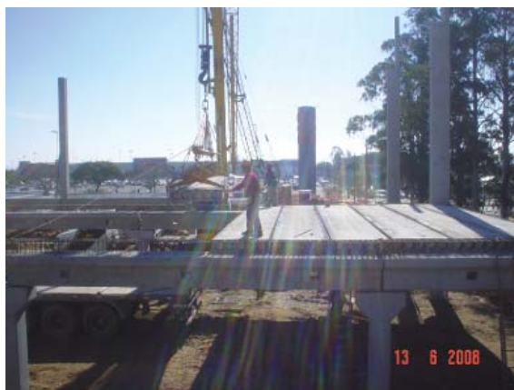
Figura 27 – A execução utilizando elementos pré-moldados de concreto está entre as tecnologias que mais expõe trabalhadores ao risco de queda
