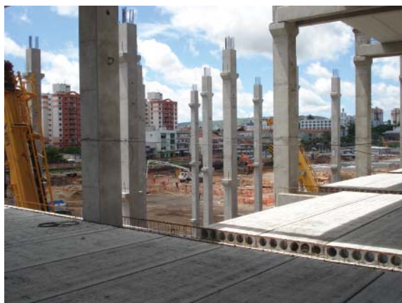
Figura 40 – Cabo de aço subdimensionado e fixado de modo inadequado nos pilares. O cabo em questão é utilizado como linha de vida
